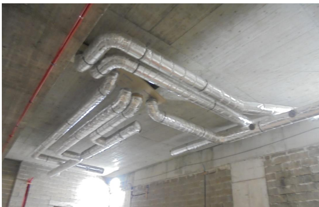
Fotografia 2 – Rede de AVAC – Bloco A
