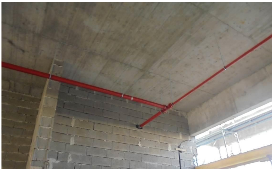
Fotografia 1 – Rede De Incêndio – Bloco A
