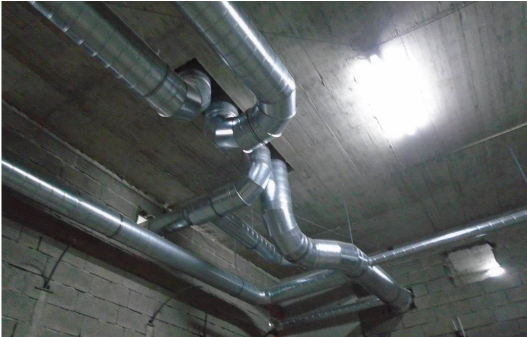
Fotografia 5 – AVAC do Piso 0 – Bloco A
