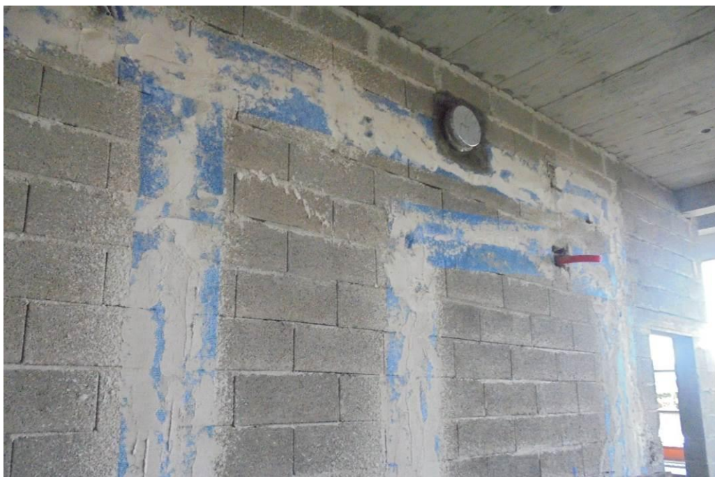
Fotografia 3 – Isolamento dos Coletores – Bloco A
