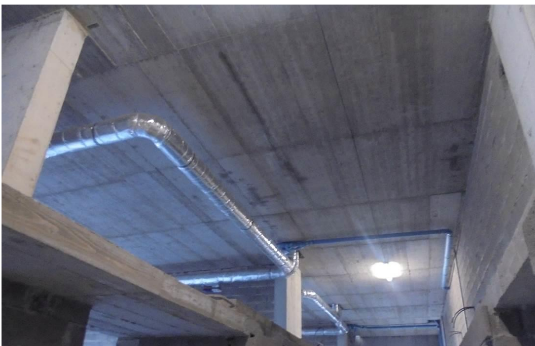
Fotografia 2 – Redes Técnicas – Bloco A – Piso 0
