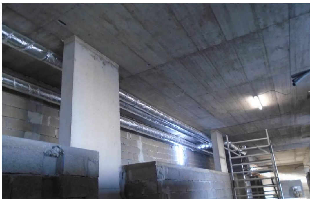
Fotografia 2 – Redes Técnicas – Bloco B – Piso 0
