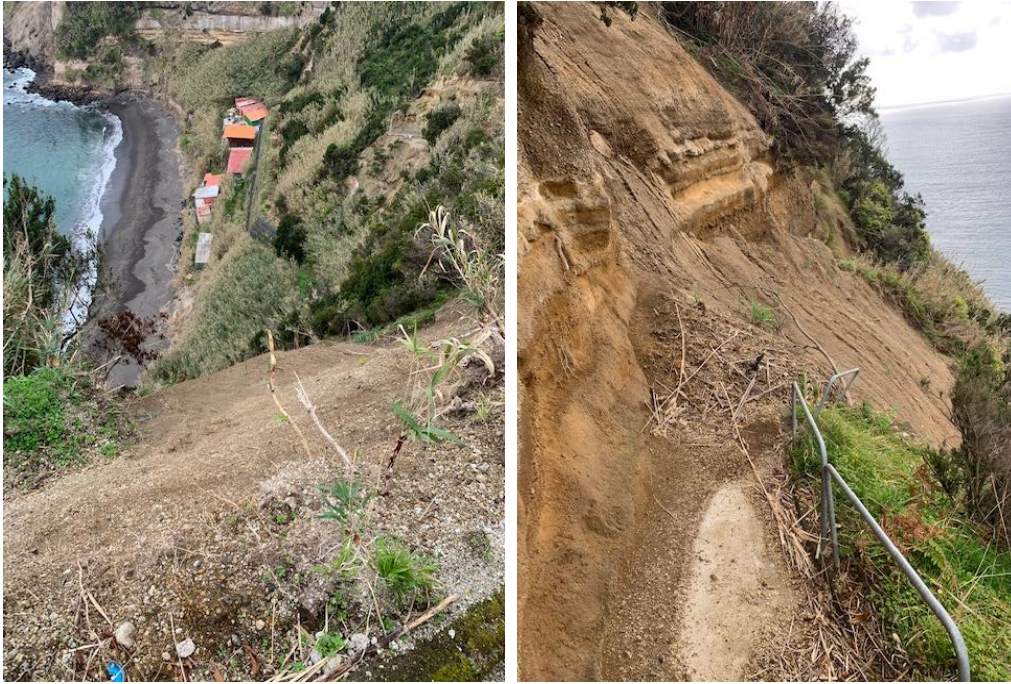
Figura 12. Derrocada na Praia da Pedreira, ilha de São Miguel. (Fonte: SAAC de São Miguel)
