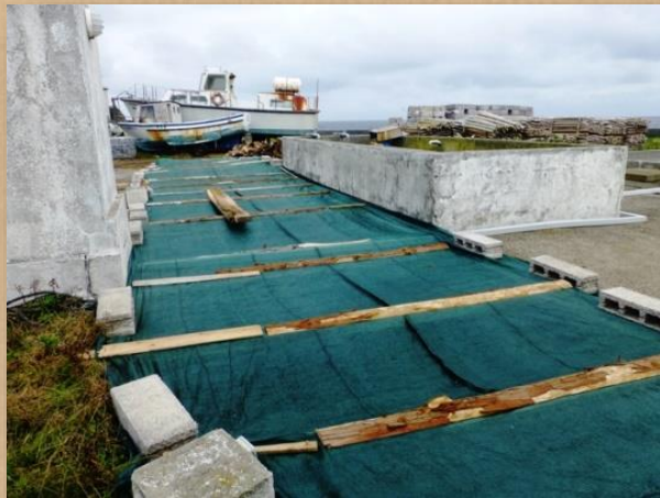
Cobertura do tanque de ETAR, na ilha do Corvo
