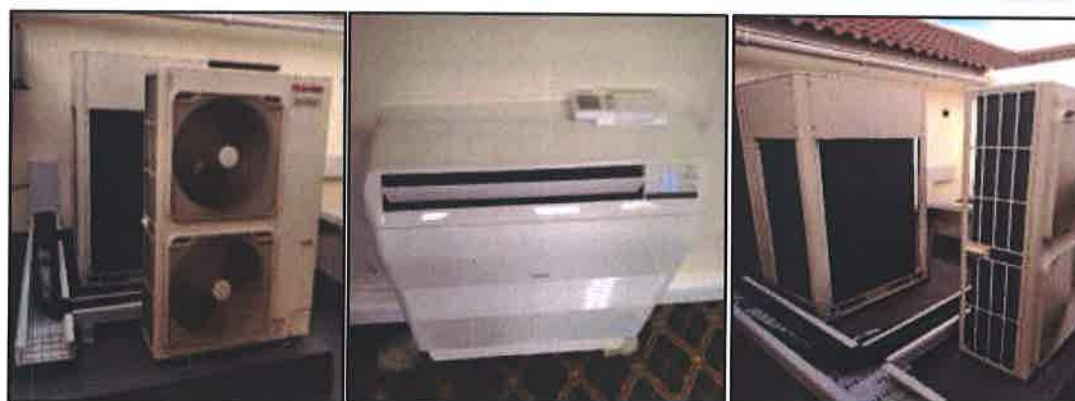
Imagem 16,17, 18, 19 e 20 – Bar Golfista e equipamentos de ar condicionado do campo de golfe da Batalha.
