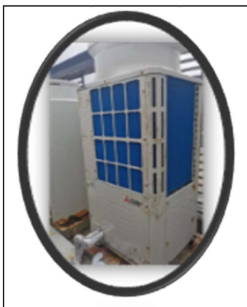
Imagem 7 - Unidade exterior de ar condicionado
